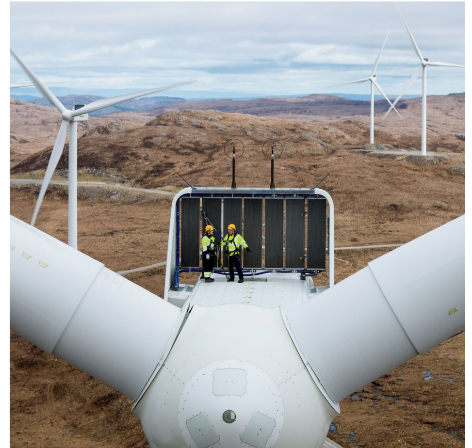
Bhlaraidh onshore windfarm
